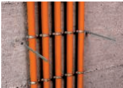
Rögzítési pontok a kábelek mellett, közvetlenül a falon
