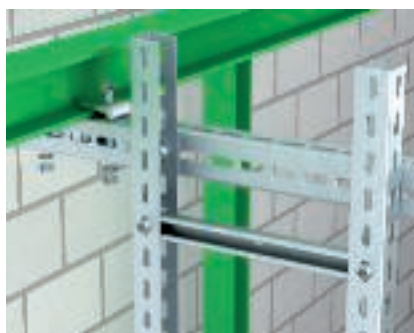
Kábelhágcsó szerelése acélszerkezetre Az SLM 50 típusú, nehéz kivitelű kábelhágcsók felszerelése U-profilból kialakított konzolos tartókkal acélszerkezetre.
