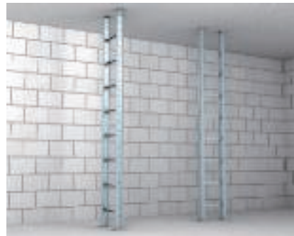
Szabadon álló kábelhágcsó alkalmazása Szabadon álló, mennyezetre és padlóra rögzített SLS típusú ipari kábelhágcsó.
